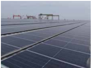
二期光伏发电板
