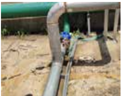
雨水收集系统
